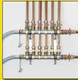
Spoelen van radiatorssystemen en wand-/ vloerverwarmingen (S/SL/SLW)
